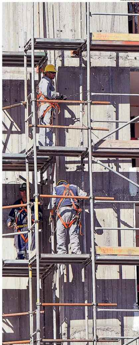
EXISTE PREOCUPACIÓN POR LAS OBRAS QUE SE ENCUENTRAN PARALIZADAS EN LA ARAUCANÍA.
